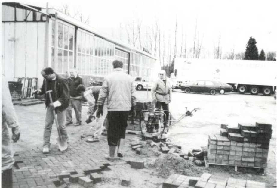
* Verwijderen van benzinetanks en herbestrating bij We-Je-Be in het kader van zelfwerkzaamheidsprojecten ten bate van de fanfare-kas.
